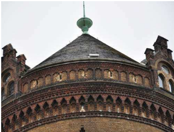
Die Außenfassade des Zerbster Wasserturms muss dringend saniert werden. Im oberen Turmbereich sind die Schäden im Klinkermauerwerk deutlich zu sehen. Foto: Daniela Apel
