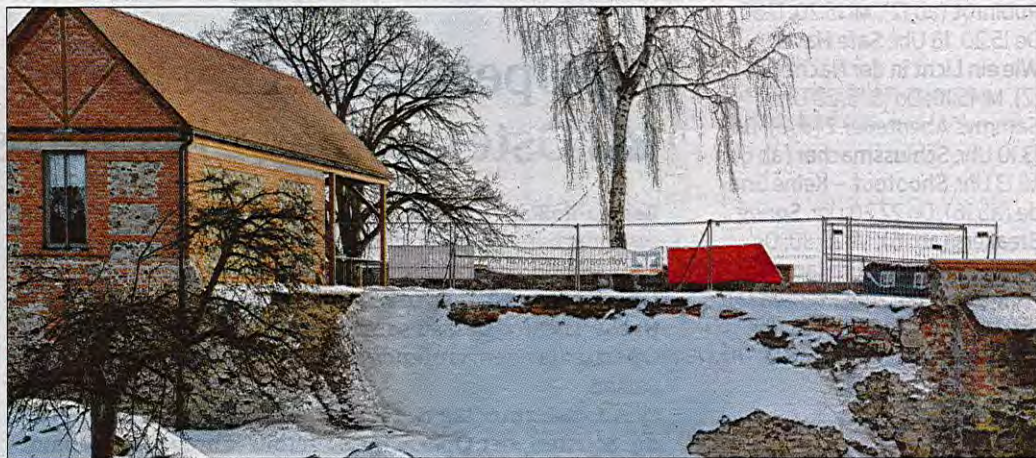
In der Mauer der Wasserburg in Walternienburg klafft ein etwa 20 Meter breites Loch. Der Antrag auf Förderung ist bereits gebilligt, so dass mit den Arbeiten bald begonnen werden kann. Foto: P. Queitsch
