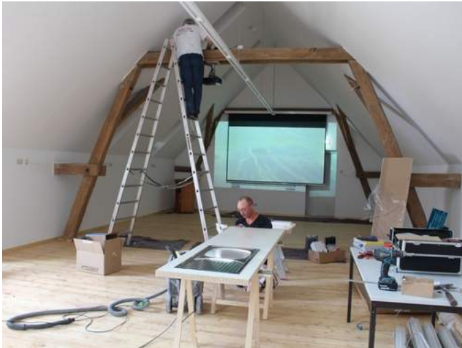
Die neuen Räumlichkeiten im oberen Bereich des Nebengebäudes sind kurz vor der Fertigstellung. Foto: Petra Wiese
